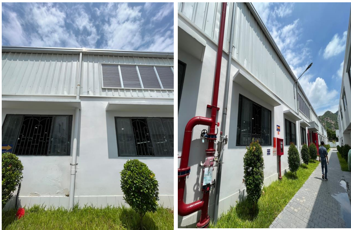
Hình 3-2: Thu gom nước mưa ở các xưởng và khu nhà ăn.
