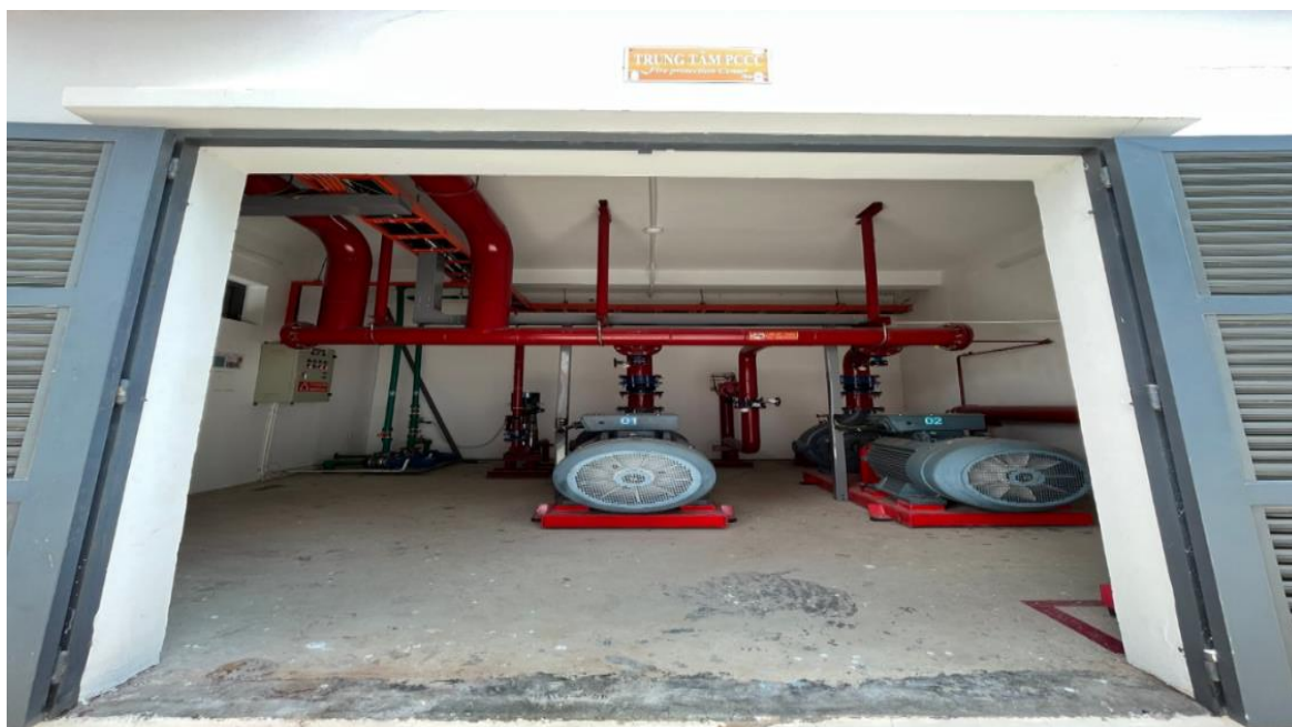
Hình 3-14: Nhà bơm phòng cháy chữa cháy
