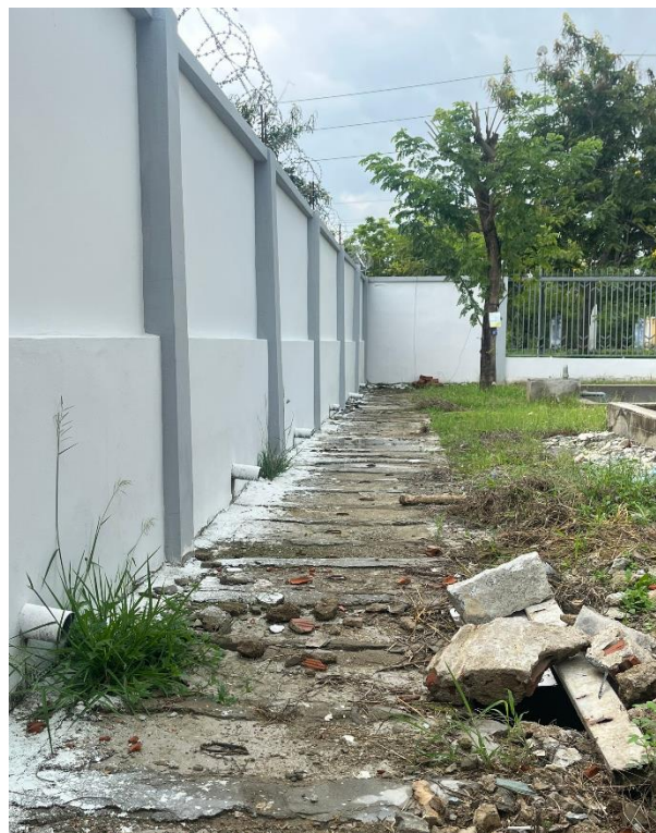
Hình 3-4: Điểm đầu nối nước mưa với hệ thống thoát nước mưa KCN Thành Hải..
